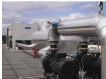
Крыша с установленными чиллерами Carrier 30GX
