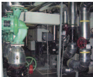
Хладоцентр, оснащенный чиллерами Carrier 30HXC
