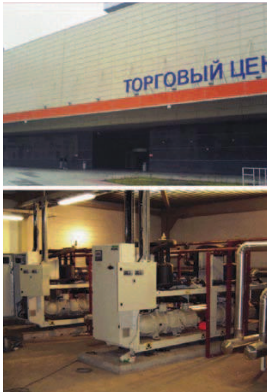
Торговый комплекс, оснащенный чиллерами
